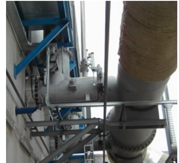
Caldera pirotubular de recuperación CRP montada.
