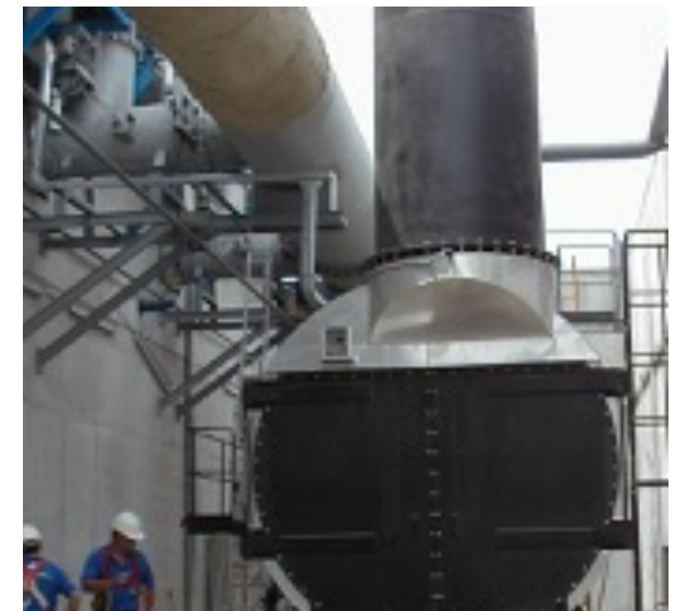
Caldera pirotubular de recuperación CRP montada.
