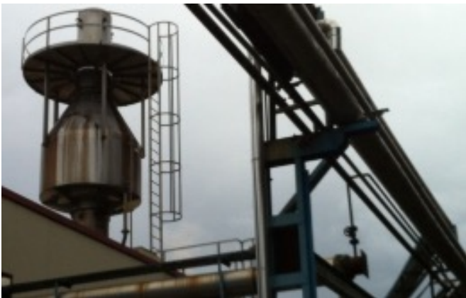
Lavador de humo LGD instalado.
