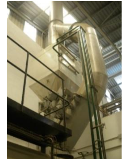
Economizador ECO instalado.
