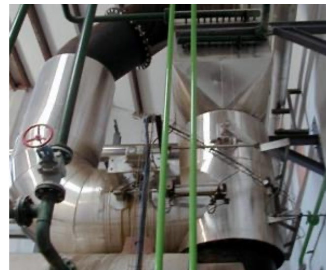
Bypass a chimenea instalado.
