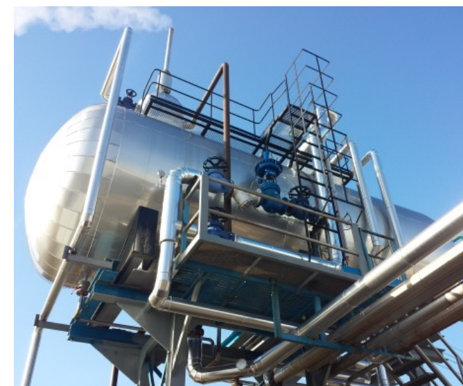
Desgasificador DGV instalado.
