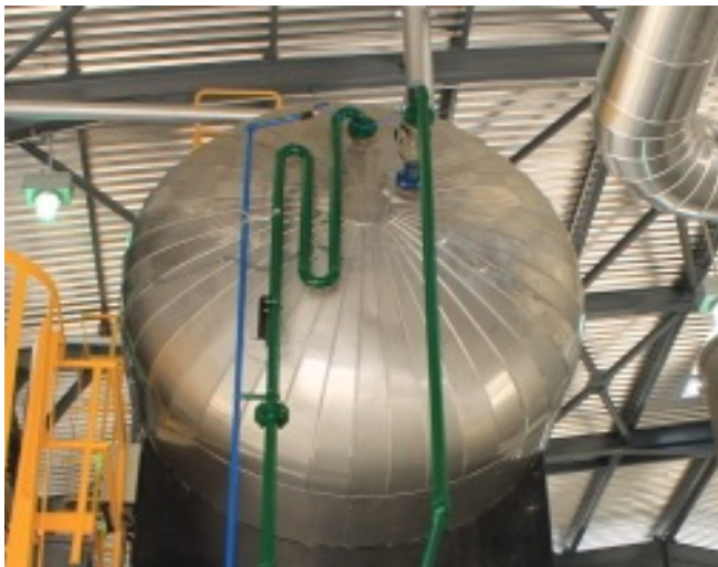
Desgasificador DGV en interior.
