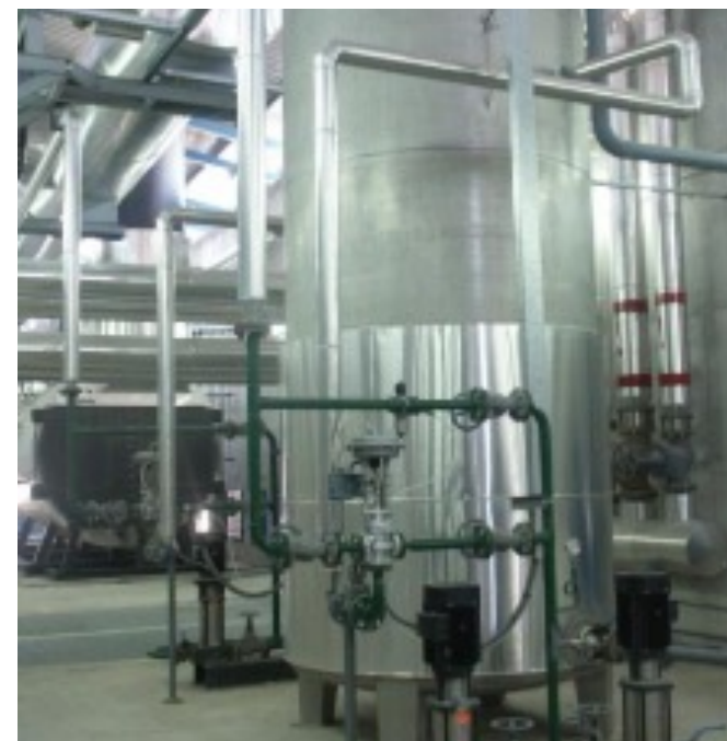
Deposito industrial instalado.
