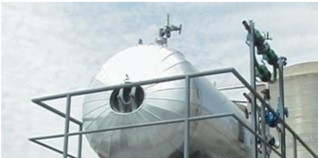
Deposito industrial instalado.
