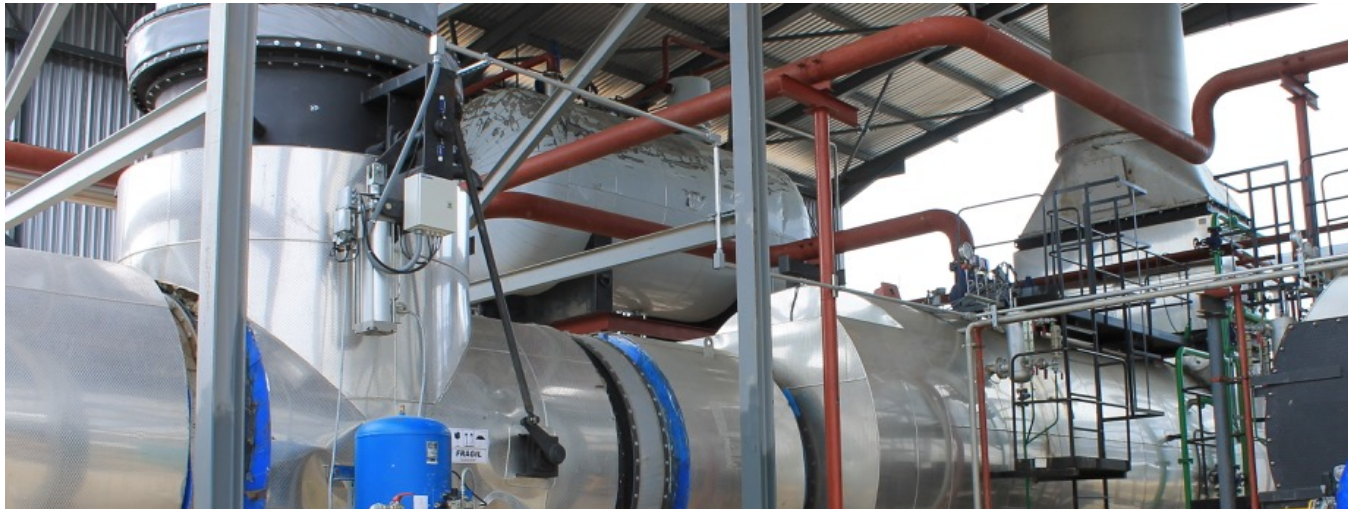
Caldera pirotubular de recuperación CRP montada.
