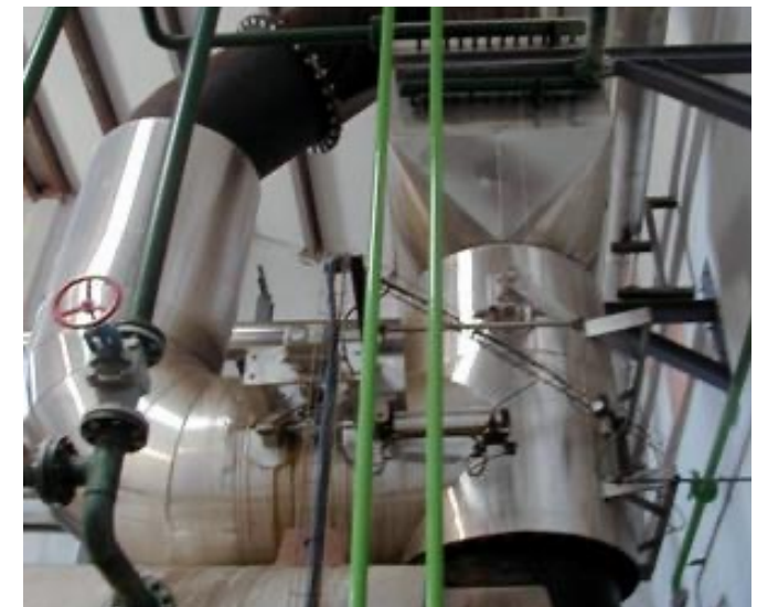
Bypass a chimenea instalado.
