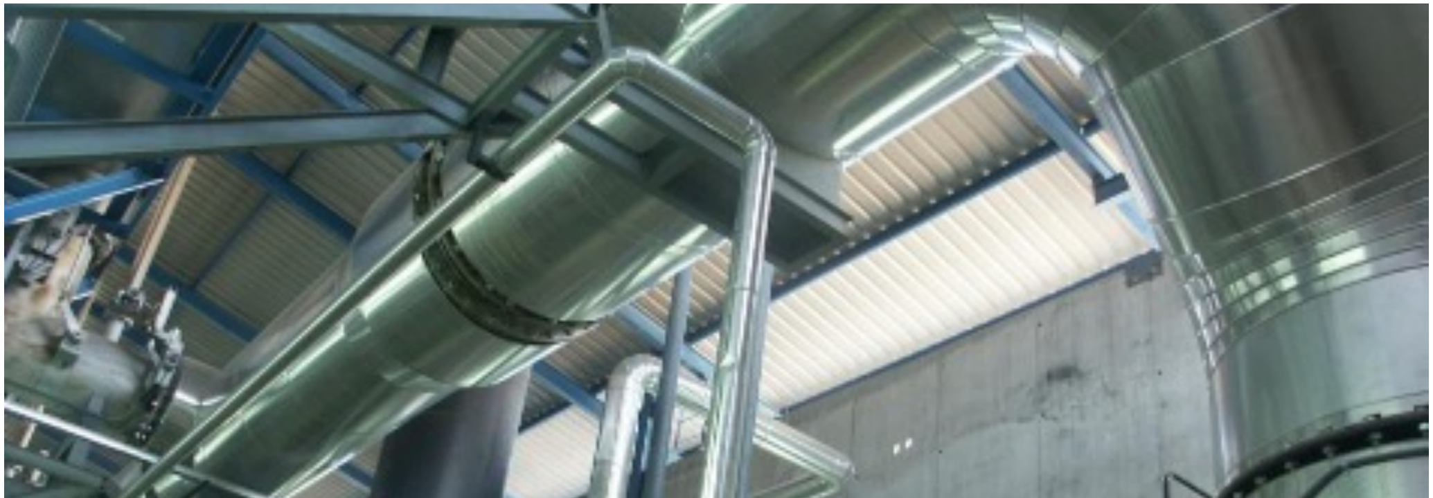
Conductos para gases aislados.
