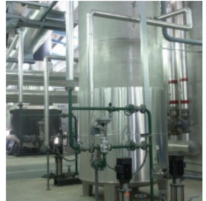
Deposito industrial instalado.
