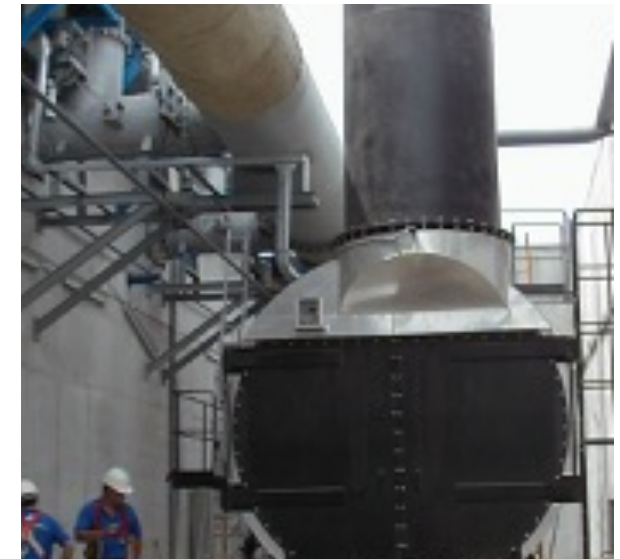
Caldera pirotubular de recuperación CRP montada.
