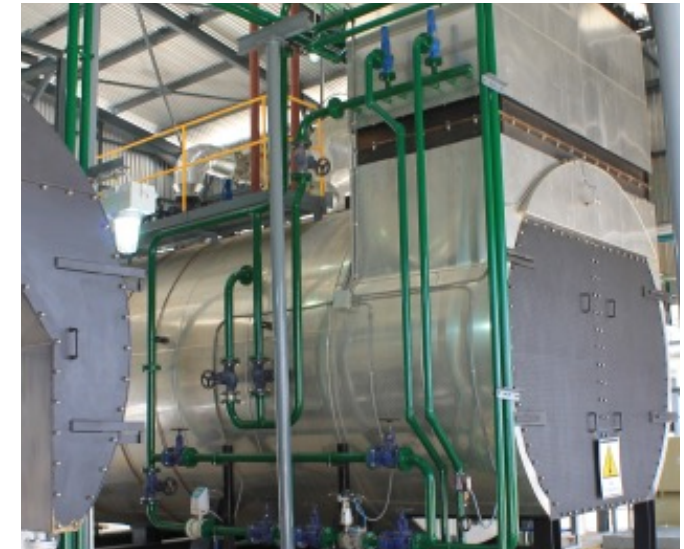
Accesorios de las calderas pirotubulares de recuperación/ cogeneración.
