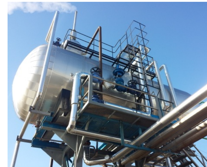
Desgasificador DGV instalado.
