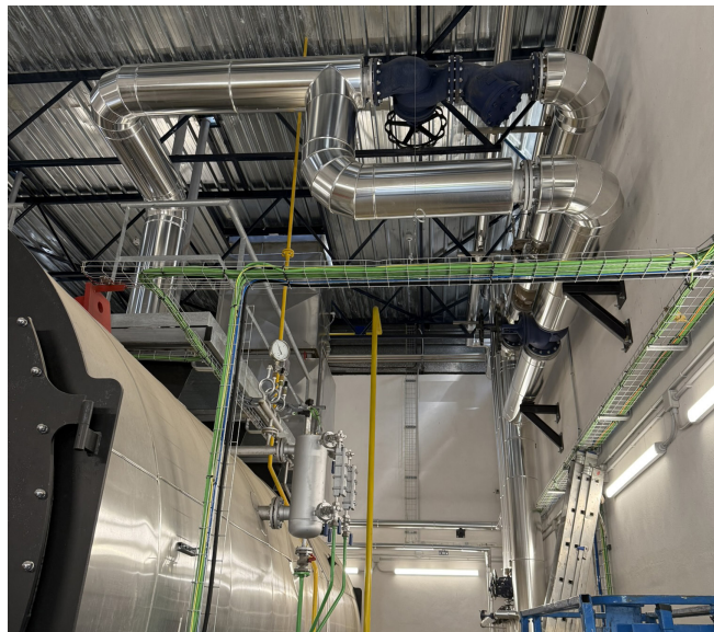
Tuberías de vapor.
