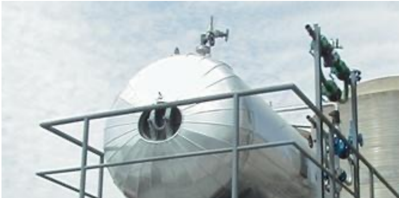
Deposito industrial instalado.
