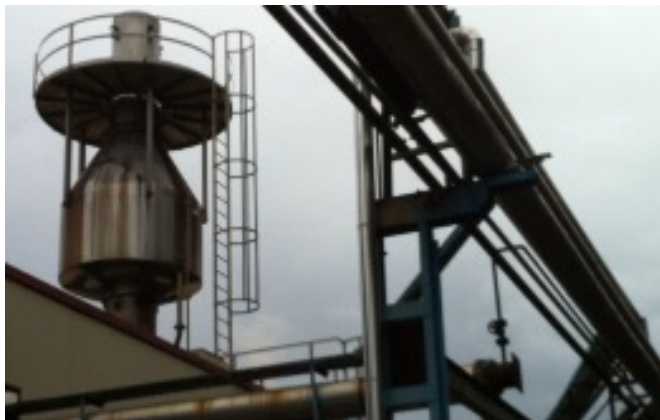
Lavador de humo LGD instalado.
