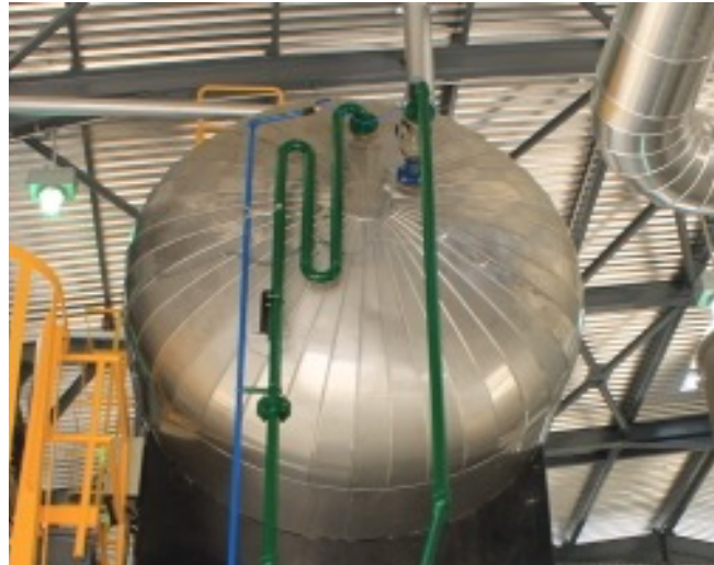
Desgasificador DGV en interior.
