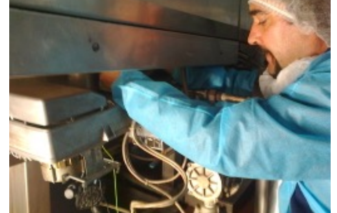
Revisión de calderas.
