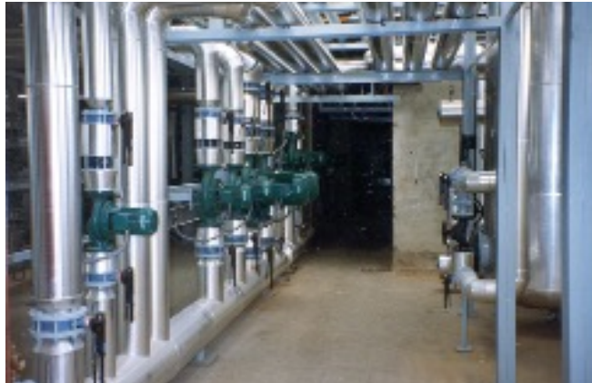
Circuito ACS instalado.
