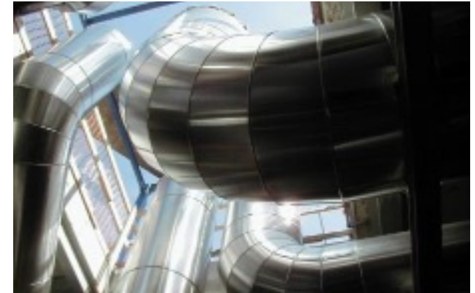
Conductos de gases de escape.
