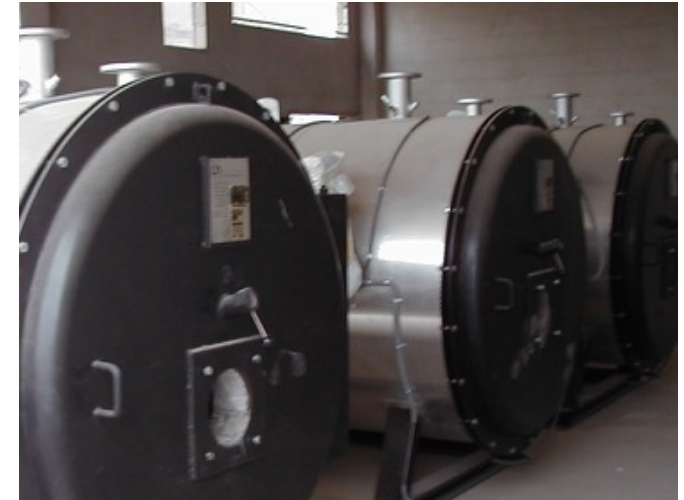
Frontales de la caldera pirotubular CBA.
